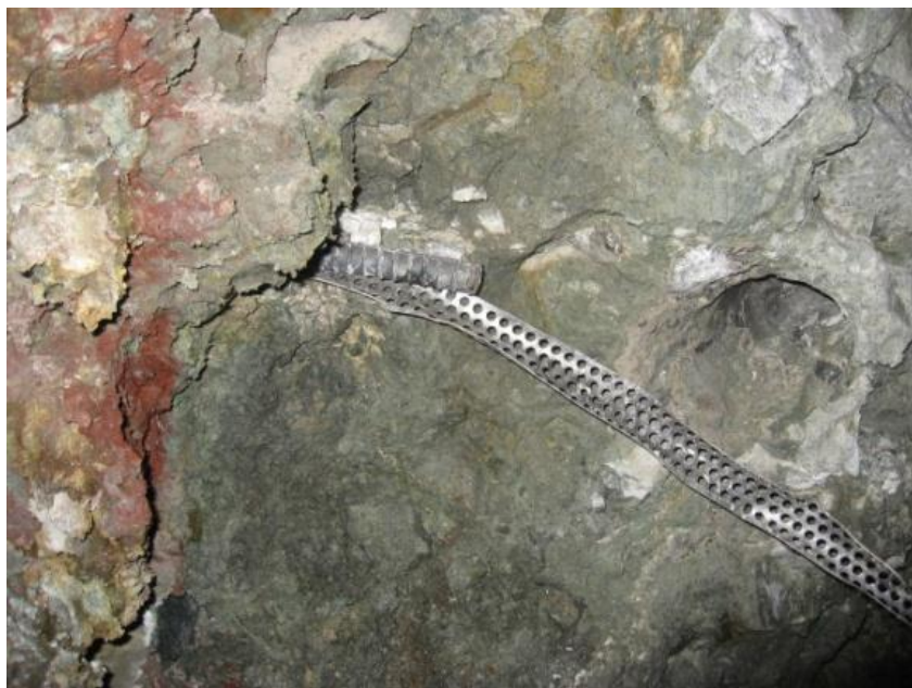
Figur 15. Bergbult och Perforör för bultmontering efter 30 år i cementbruk i Bolmentunneln. Bultstål och Perforör för ingjutning av bult visar inga synliga tecken på korrosion (Foto: Bogdanoff 2010).
