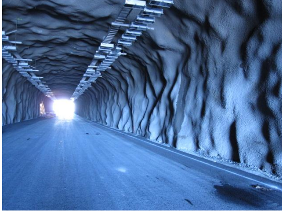
Figur 9. En av motorvägstunnelarna mellan Västerås och Enköping. De mörka fläckarna på asfalten är läckage från taket. Trots att man inte har utfört dyrbar och tidsödande förinjektering är läckagen relativt få (Foto: Bogdanoff, 2011).
