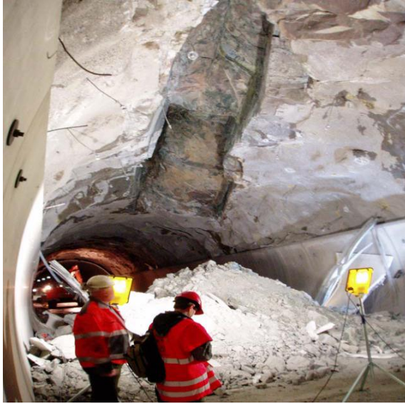
Figur 22. Raset i Hanekleivtunneln, E18 i Norge, hände 10 år efter att tunneln togs i bruk. Rasmassorna från det 25 m långa raset trycktes genom sprutbetongen och vidare genom liningen. Vid tiden för byggnation hade sprickbildning observerats i sprutbetongen. Den kompletterande förstärkningen blev dock otillräcklig. Foto från skadeutredningen Bollingmo m.fl. 2006).
