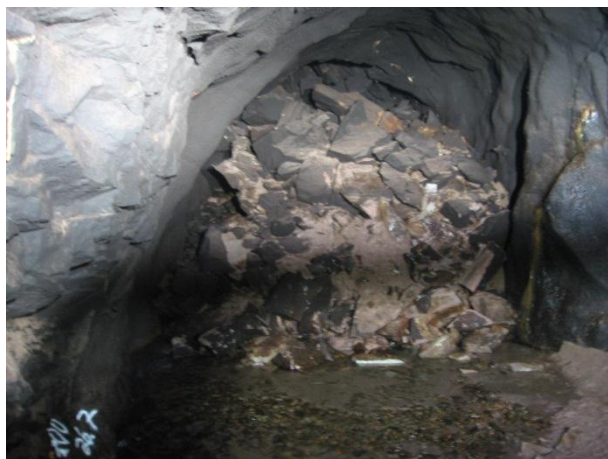
Figur 23. Raset 2008 i Bolmentunneln skedde i ett område där tunneln hade förstärkts med närtarmerad sprutbetong. (Foto: Bogdanoff 2009).
