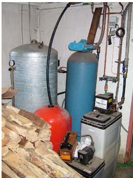
Figur 23. Hydrofor och filterinstallationer i fastighetens källare. Filtren är installerade för att för att reducera halterna av järn, mangan, humus och höja pH men däremot inte för att reducera radonhalten (Foto: Britt-Marie Ek).
