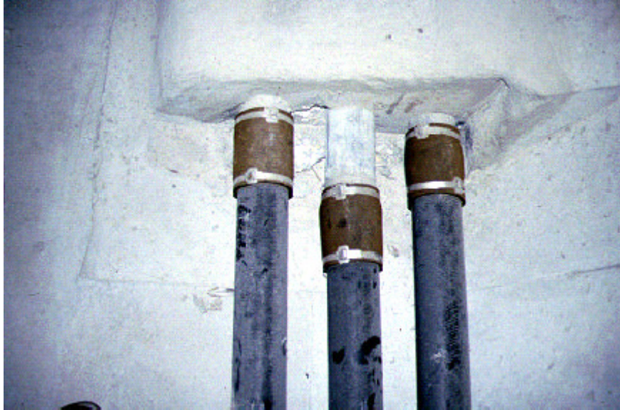
Figur 32: Förskjutning av kabelrör intill ankare i Niles Channel Bridge. (Corven 2002, Vol. 1)
