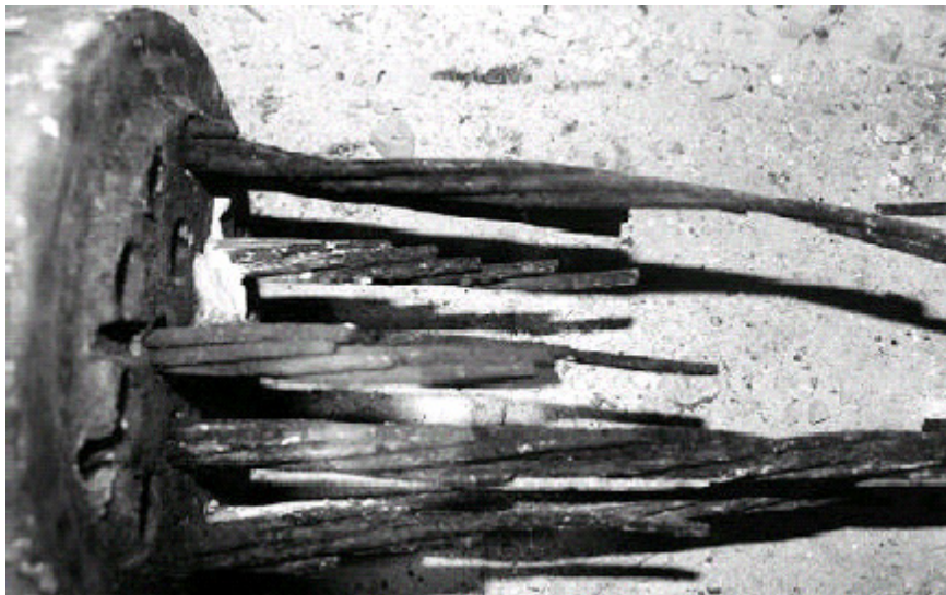
Figur 33: Långt framskriden korrosion av spännkabel vid ankare i Niles Channel Bridge. (Corven 2002, Vol. 1)
